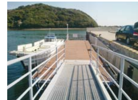
渡船浮棧橋 4m×15m の渡船用浮棧橋です。外周にはステンレス製手摺り、先端には照明設備を設けました。
